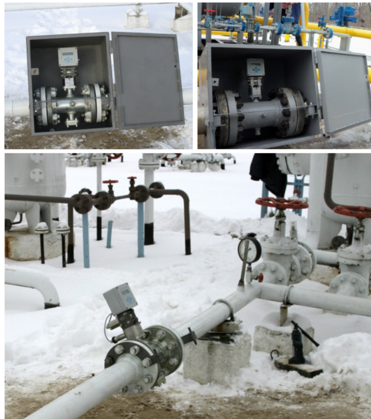
Витратомір-лічильник РГ-ОНТ в експлуатації
